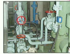
機械の冷却水
