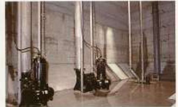
排水ポンプ 調整池に貯留した雨水を晴天時に、下水管渠へ排水します。
