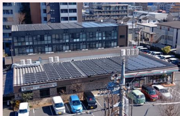
民間商業施設における大規模太陽光発電システム
