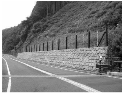
落石防護柵工
