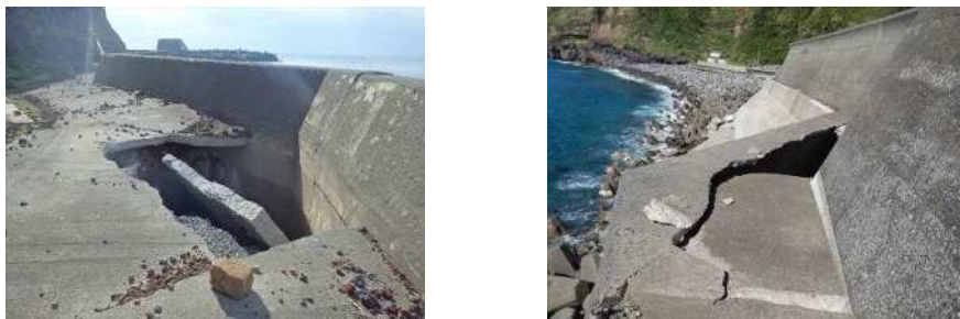
老朽化による施設の破損状況 (左)御蔵島、(右)三宅島
