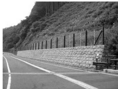
落石防護柵工
