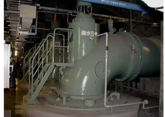
雨水排水ポンプの増強 《先行待機型ポンプ》
