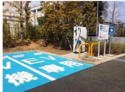
<公共用急速充電設備設置イメージ>
