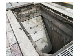
都営地下鉄の通風口浸水防止
