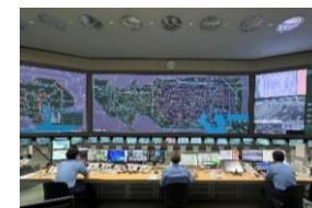
交通管制センター
