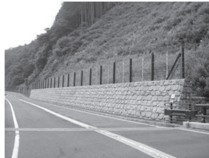
落石防護柵工
