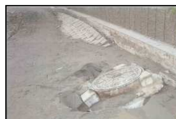
液状化による浮上（新木場）
