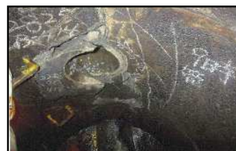
接続部の破損（新木場）
