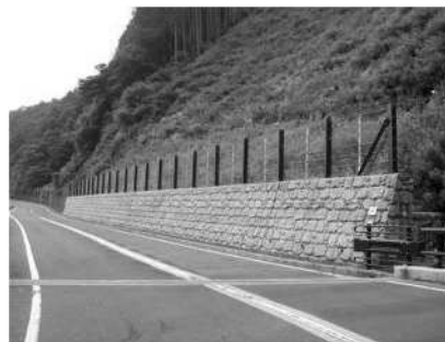
落石防護柵工
