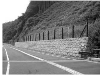
落石防護柵工
