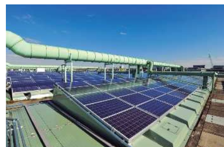
太陽光発電設備を導入
