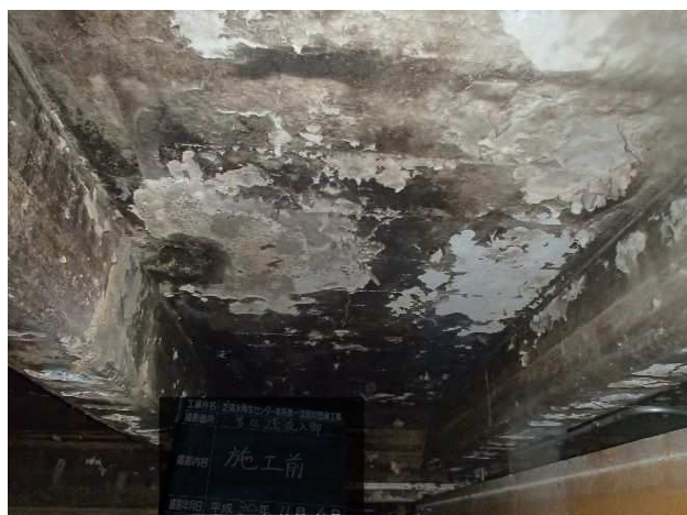
老朽化した水再生センター
