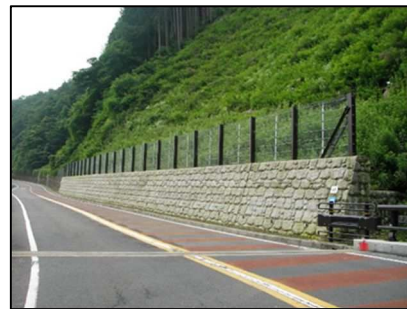
落石防護柵工
