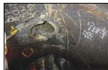
接続部の破損（新木場）
