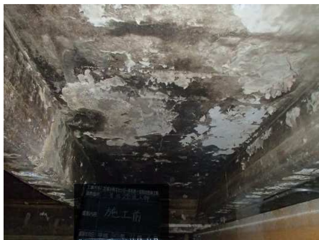
老朽化した水再生センター
