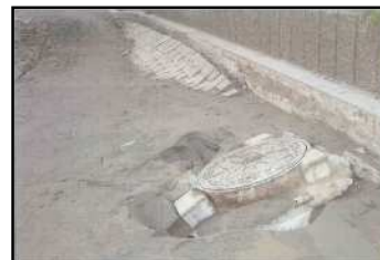
液状化による浮上（新木場）
