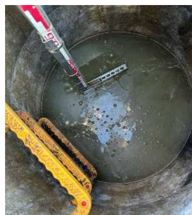
人孔内の土砂閉塞（羽咋市）
