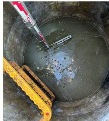
人孔内の土砂閉塞（羽咋市）
