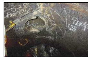
接続部の破損（新木場）
