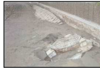
液状化による浮上（新木場）
