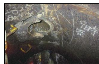
接続部の破損（新木場）
