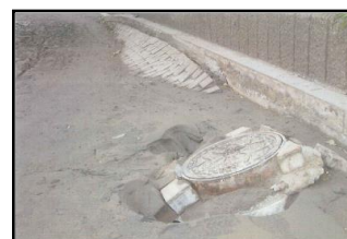
液状化による浮上（新木場）
