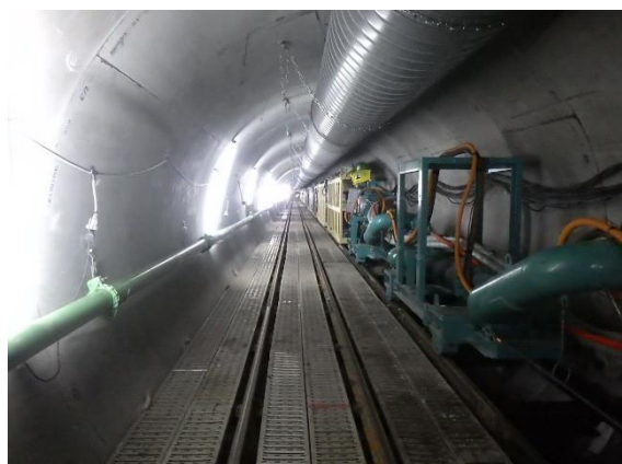
浸水対策幹線の整備 《呑川増強幹線》
