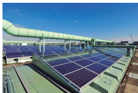
太陽光発電設備を導入
