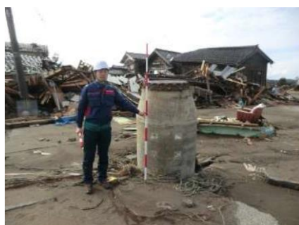
液状化による浮上（珠洲市）
