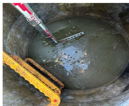
人孔内の土砂閉塞（羽咋市）
