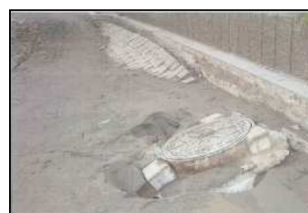
液状化による浮上（新木場）
