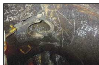
接続部の破損（新木場）
