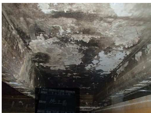
老朽化した水再生センター
