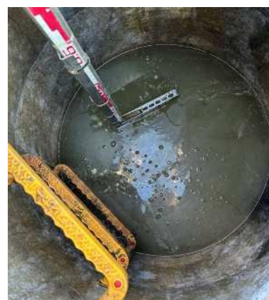
人孔内の土砂閉塞（羽咋市）
