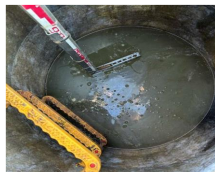
人孔内の土砂閉塞（羽咋市）
