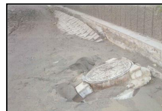
液状化による浮上（新木場）
