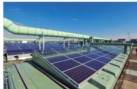
太陽光発電設備を導入
