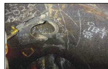
接続部の破損（新木場）
