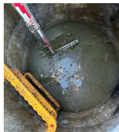
人孔内の土砂閉塞（羽咋市）
