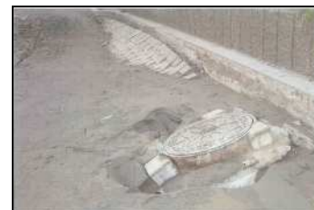
液状化による浮上（新木場）
