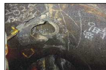
接続部の破損（新木場）
