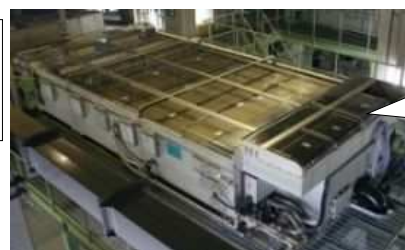
省エネルギー型汚泥濃縮機
