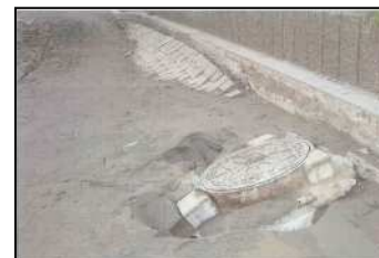
液状化による浮上（新木場）
