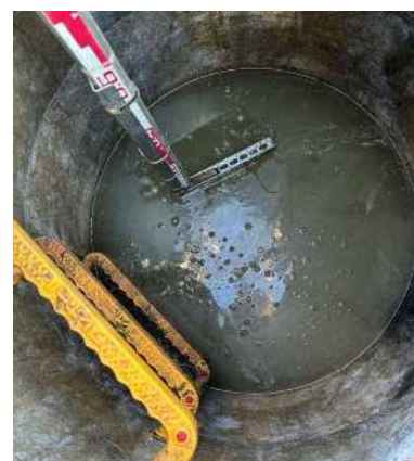
人孔内の土砂閉塞（羽咋市）
