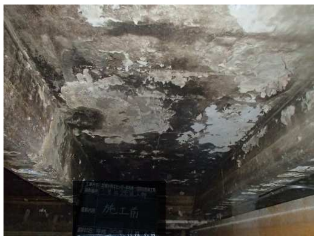
老朽化した水再生センター
