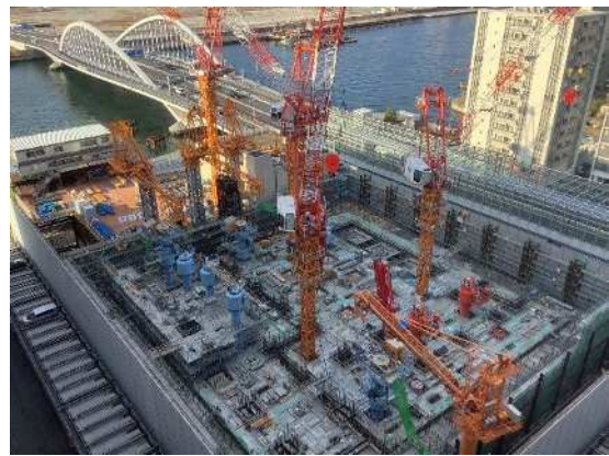
雨水ポンプ所の整備 《勝どきポンプ所》
