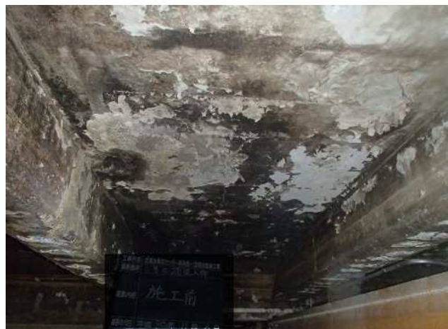
老朽化した水再生センター
