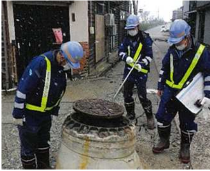
液状化による人孔浮上
