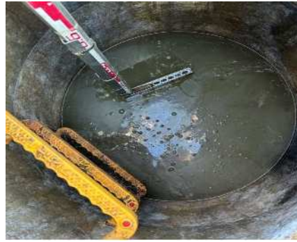
人孔内の土砂閉塞（羽咋市）
