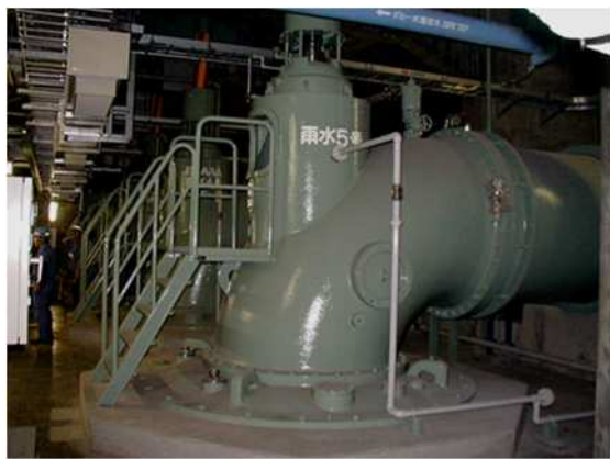
雨水排水ポンプの増強 《先行待機型ポンプ》
