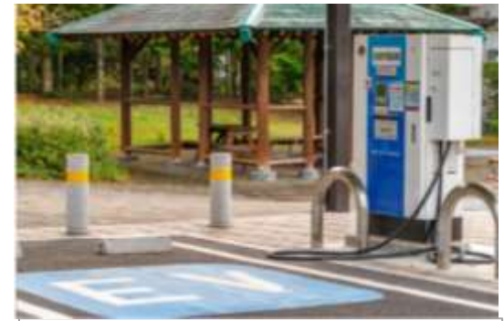
EV充電スタンド
