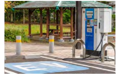
EV充電スタンド
