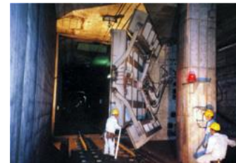
トンネル内防水ゲート
